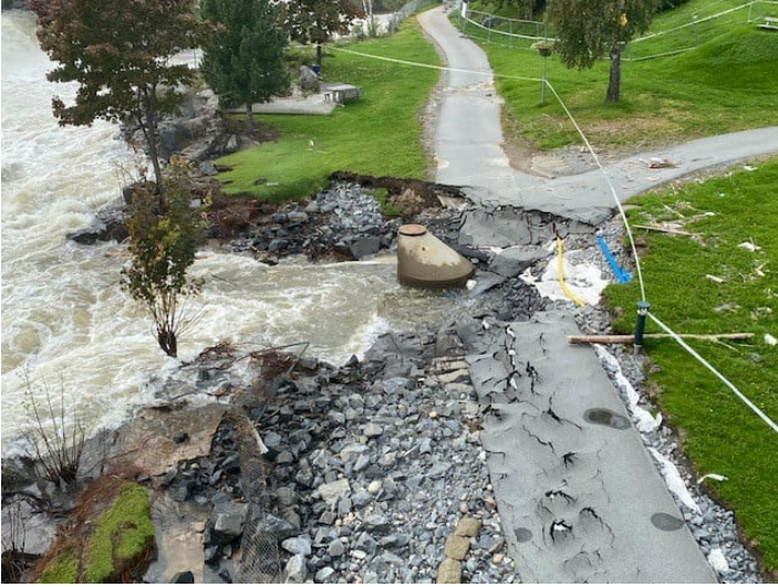
FLOMSKADER: Her har Hønefossen gjort innhugg i landskapet etter store nedbørmengder i 2023. (Foto: Anne solheim)
